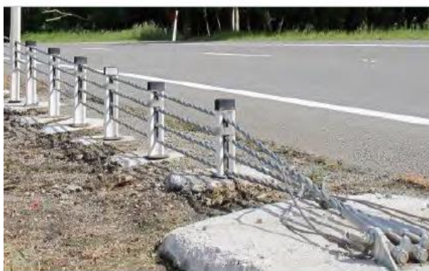
Ilustración 10. Terminal en barrera de seguridad de cables
