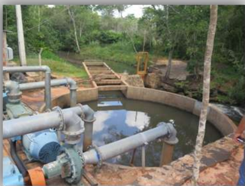
Ilustración 29: Fuente de agua que combina succión directa del arroyo y pequeño reservorio de agua, Guayaibí - San Pedro
