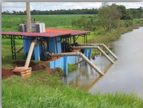
Ilustración 27: Planta de bombeo de un reservorio de agua represado, Estancia Rosa Acre-Canindeyú
