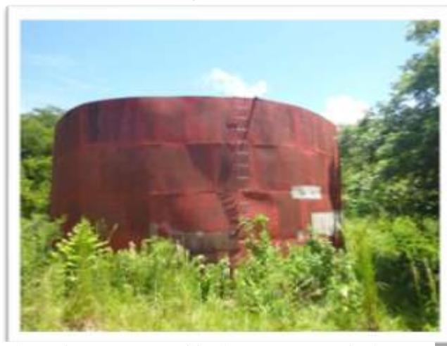
Ilustración 3. Tanque utilizada como reservorio de agua.
